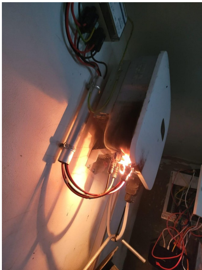
1 Wochen nach der Überflutung fängt Wechselrichter Feuer
