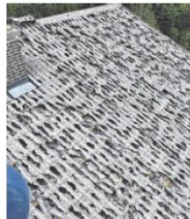
Zerstörtes Dach Foto: FF Frankenmarkt
