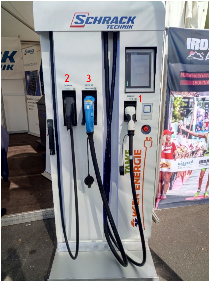
Abbildung 48: Ladesäule für Elektrofahrzeuge (E-Tankstelle) (Wolfgang Niederauer, ÖBFV)
