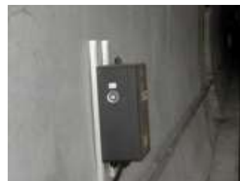
Einschalter für Beleuchtung
